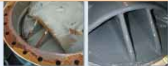
Ruostunut läppäventtiili – ennen ja jälkeen korjauksen
